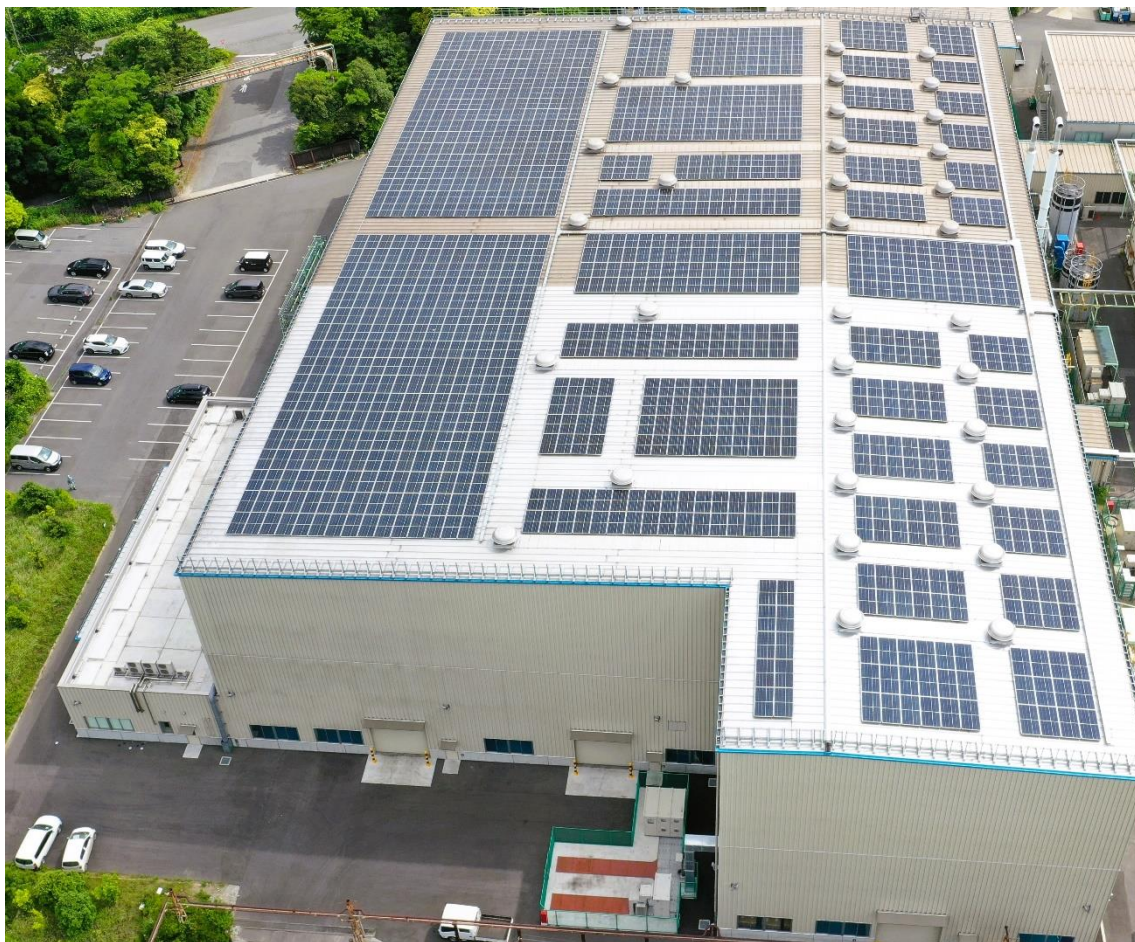
【機能素材製造所ニッケル超微粉第5・第6工場 屋上太陽光発電設備】
